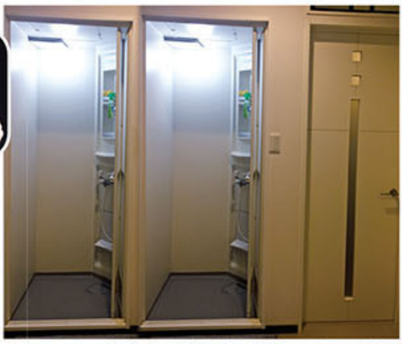
▲シャワー個室(扉付き)2室(シャワー4台)
