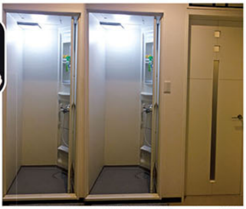
▲シャワー個室(扉付き)2室(シャワー4台)
